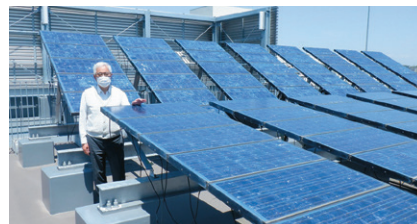
写真：研究実験棟Ⅲ屋上に設置の太陽電池モジュール
